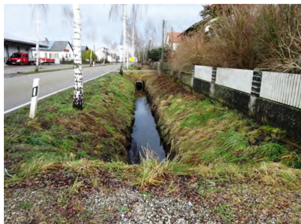
Foto 27: Straßengraben von Brücke Anwesen Haberl Richtung Kirche Vorschlag: Verrohrung zum Bau eines Fußwegs
