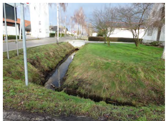
Foto 25: Straßengraben Kreuzung Ortszentrum – Pöttmeser Straße, Richtung Osten Vorschlag: Verrohrung zum Bau von „Inseln“
